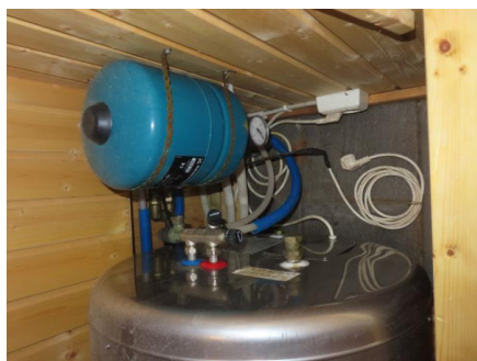
Tekniske installasjoner. Trykktank.
