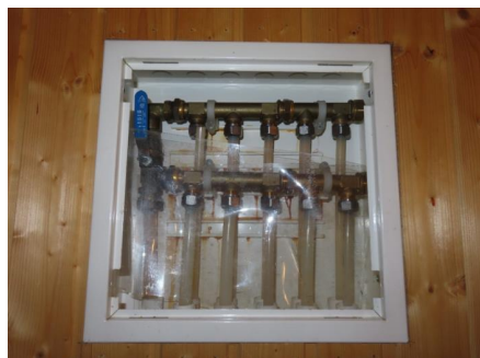
Samleskap for trykksatte rørføringer.
