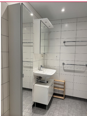
Begge badene er innredet med dusj, toalett og vask med høy og underskap.
