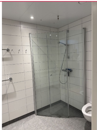
Varmekabler i gulv.
