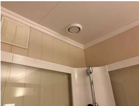
Avtrekk bed underetg.
