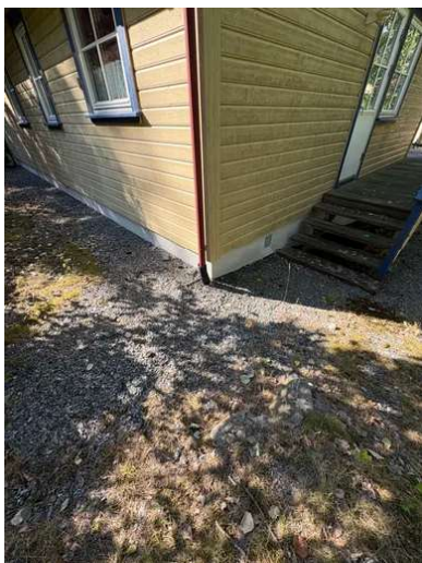
Nedløp ført til drenør
