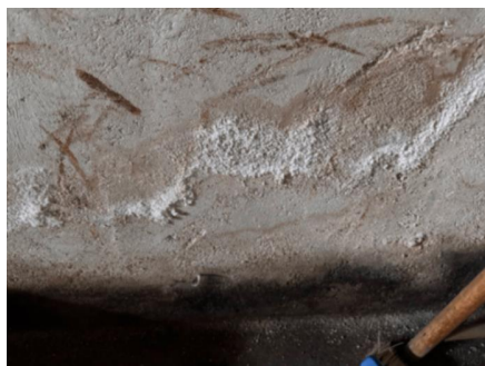
Saltutslag og fukt i kjellervegger
