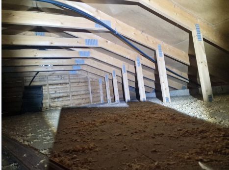
Råteskader i tak innerst til høyre.
