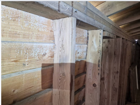
Mugg og sopp innvendig kledning
