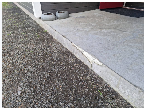
Platestykker falt av ved inngangsparti.
