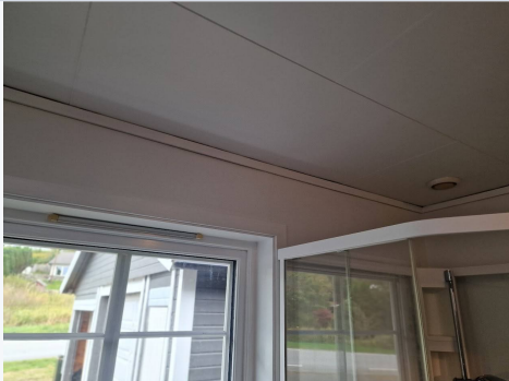
Ventil i vindu og i tak.
