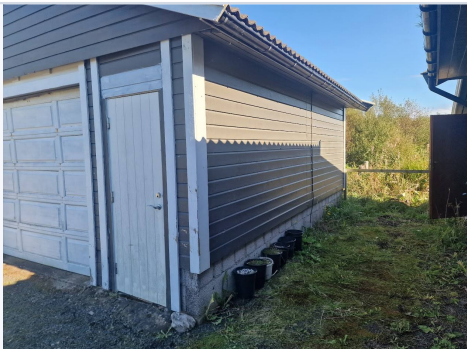
Ikke pussede murer, port i dårlig stand
