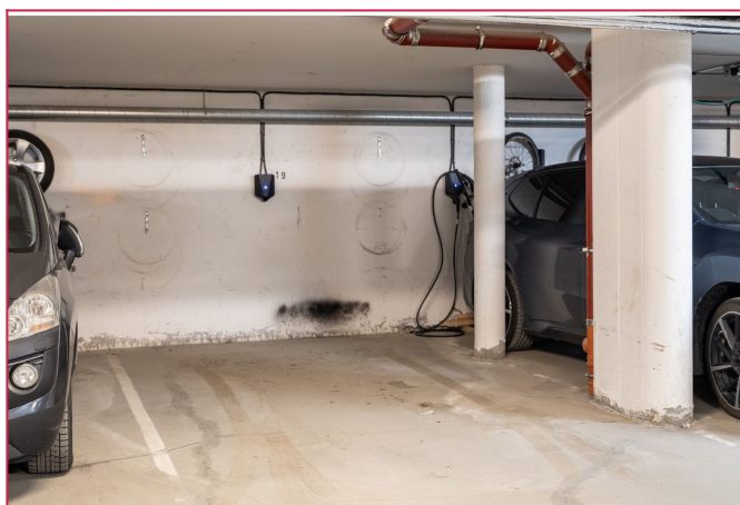
Parkering med elbillader
