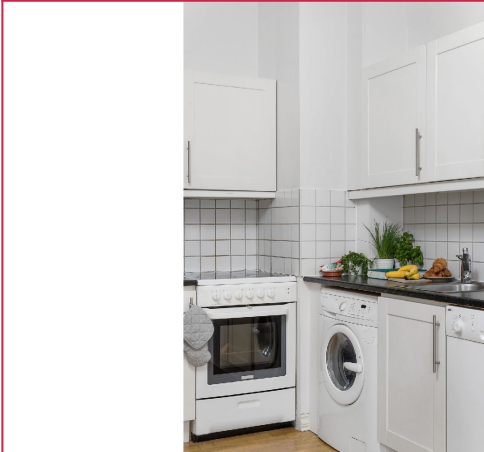
Opplegg for vaskemaskin på kjøkkenet.
