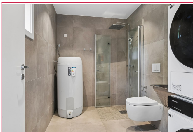
Her er det vaskerom/bad med både vaskemaskin og tørketrommel.
