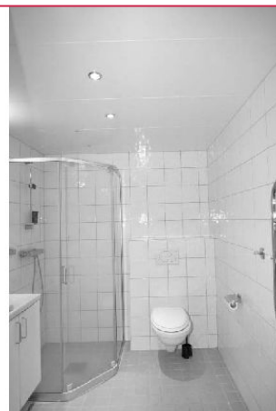
Bad - Varme i gulv og opplegg for vaskemaskin.
