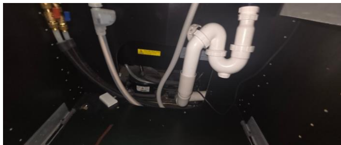
Wather Guard ( vannstoppesystem ) i kjøkkenbenk.
