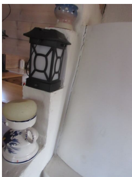
Sprekk mellom elementpeis og brannmur
