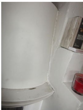
Sprekk mellom elementpeis og brannmur
