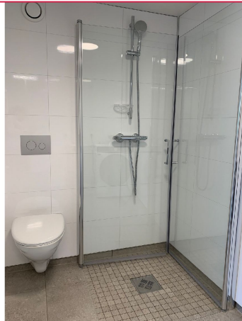
Badet har fliser på gulv og baderomsplater på vegg - Varme i gulv
