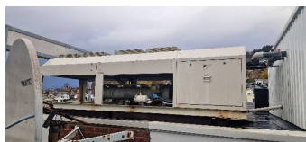
Ventilasjonsanlegg på tak. Forberedt for kjøling iflg. eier
