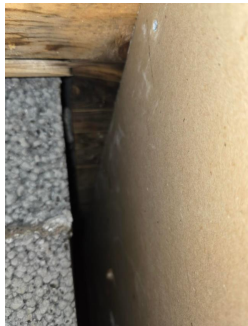
Misfarging av undertak ved pipe.
