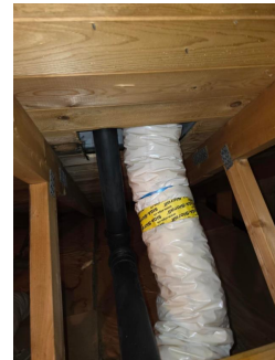
Litt misfarging av undertak ved luftehatt.
