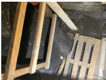
Synlig vann i krypkjeller.
