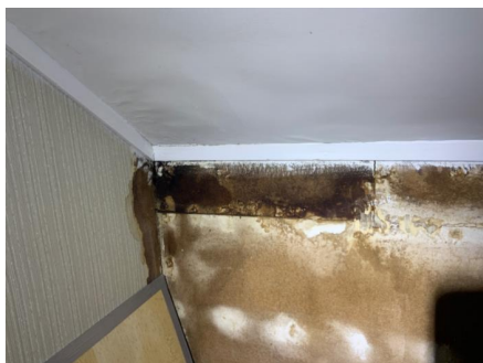
Fuktmerker på vegg på loftet.
