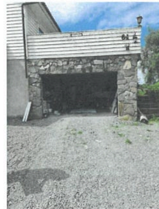
Garasje utan støpt golv og utan port.
