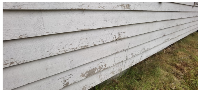
Kledning som manglar måling
