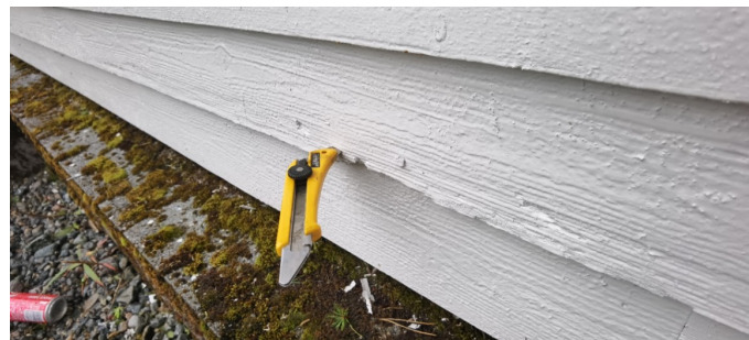
Roteskada kledning austvegg
