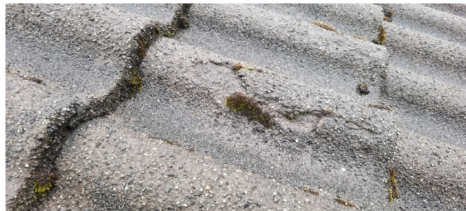
Skade i takstein
