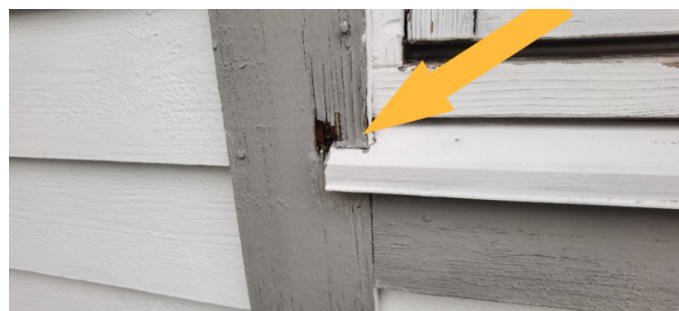
Overgang listverk/beslag, her roteskada
