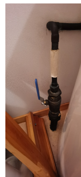
Hovudstoppekrane ved golv i leilegheit nr. 2
