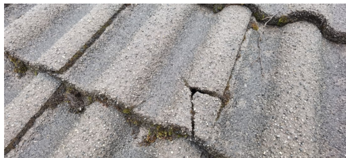
Skade i takstein
