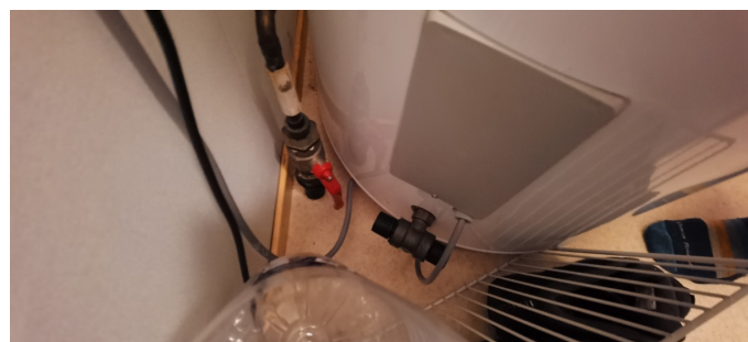
Hovudstoppekrane ved golv i leilegheit nr. 3
