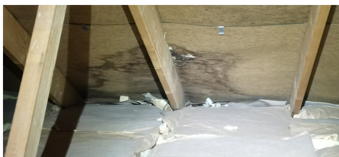
Missfarga og oppfukta undertak
