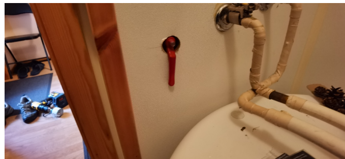
Hovudstoppekrane ved vegg i leilegheit nr. 1
