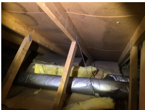
Begrenset lufting i nedkan
