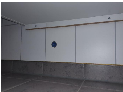
Avrenning fra rør i rør skap.
