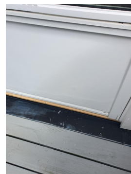
Ser fuktmerke på brystning nede mot terskel på terrasse dør mot sør.
