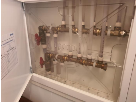
Rør i rør skap med stoppekran.
