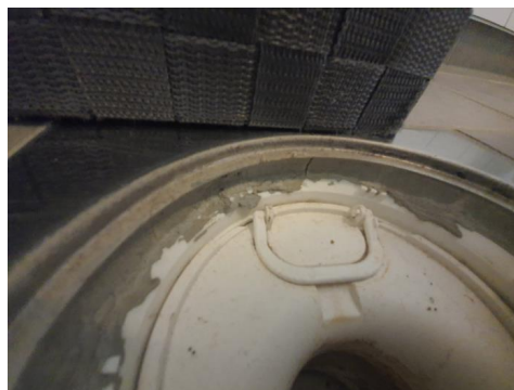
Membran og mansjett under klemring for sluk.
