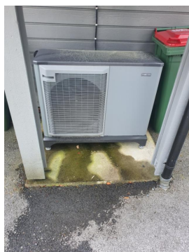
Felles utedel forvarmeanlegget
