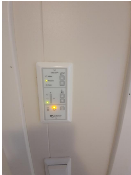
Lyset på display er varmeveksler som ikke skal være i bruk.
