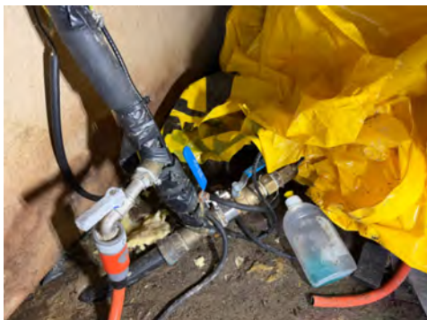
Stoppekrane er plassert i kjeller.
