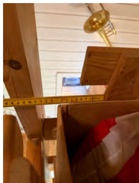
Åpninger i rekkverk mot trapp.
