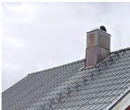
Tegn til rust mot pipehatt
