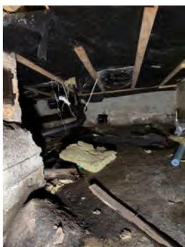
Klemlekter har påbegynte råteskader og mangler stedvis.
