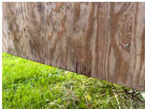
Slitasje i nedkant av døren.
