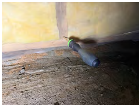
Svertesopp og råteskader i treverk.
