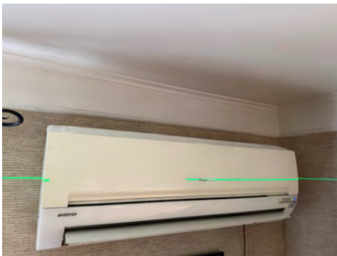
Varmepumpe innvendig del.
