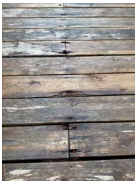
Terrassedekket er værslitt og har stedvis påbegynte råteskader.
