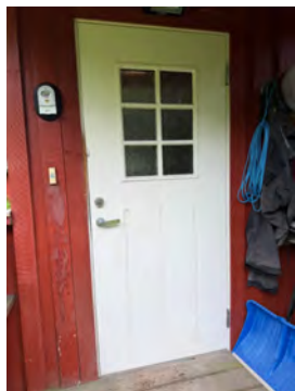
Ytterdør, stedvis slitasje i overflate dørblad.
