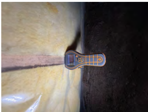
21,8% ved fuktmåling i trevegg mot mur.
