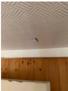
Skade mot taket på soverom i loftsetasjen
