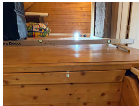
Store lokale skjevheter i gulvet i loftsetasjen.
