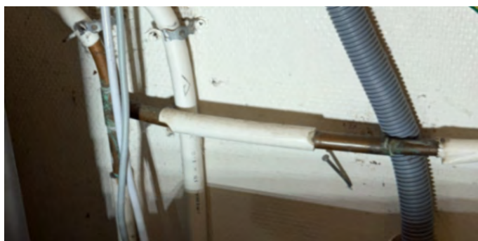
Irr på kobberrør.
