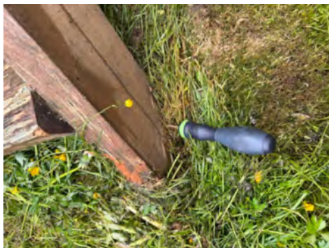
Påbegynte råteskader i søyler mot mark.
