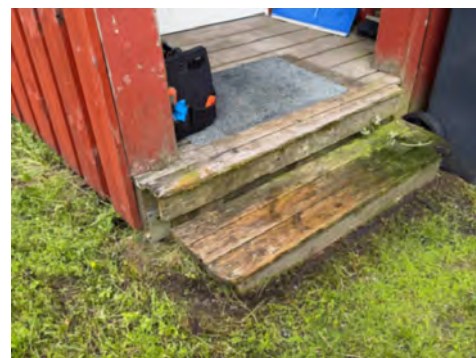
Trapp og dekket har råteskader og er etablert direkte mot mark.
