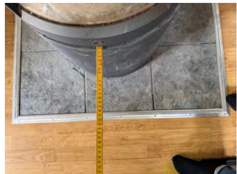
Ildfast plate på gulv under vedovn i stue er for liten.
