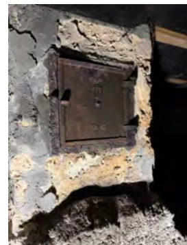
Manglende låsing for sotluke, skorstein i krypkjeller har avflassing av murpuss.
