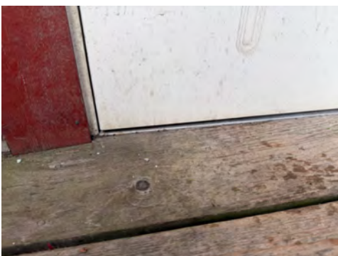
Manglende beslag i nedkant, døren er etablert nærme terrassedekket.
