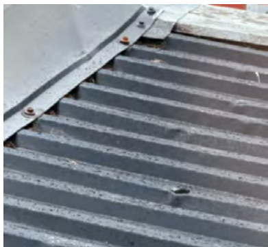
Skade i yttertekking takplate.
