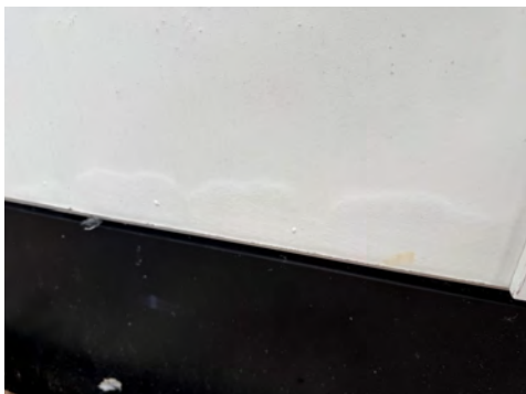
Svellinger i nedkant av balkongdøren.
