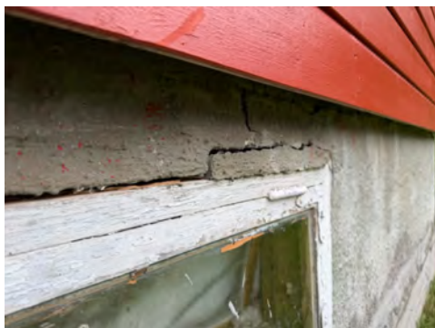
Sprekker i mur over kjellervindu
