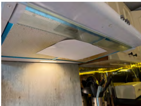
Funksjonstest av ventilator.
