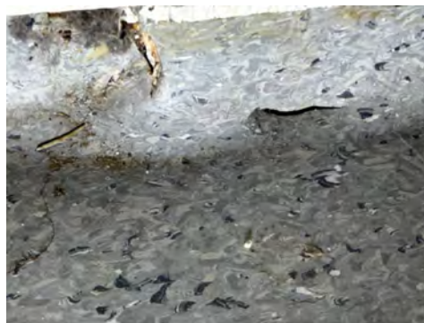
Skade i vinylbelegg.
