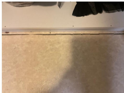
Åpen skjøt i belegget.
