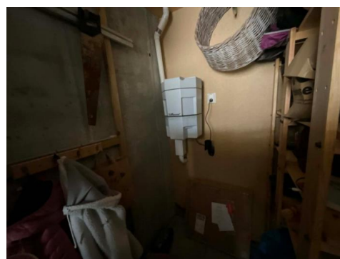
Sentralstøvsuger plassert i utvendig bod.
