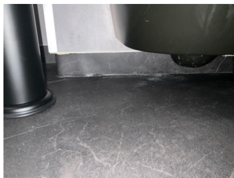
Ikke synlig drenshull under veggghengt klosett.
