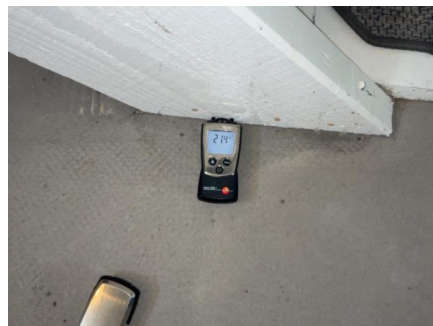
Høyt fuktinnhold i treverk på trapp til kjeller.
