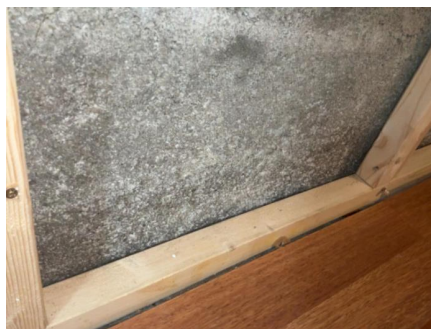
Det er noen steder saltutslag på vegger.
