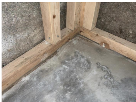
Det er noen steder fuktmerker på treverk.
