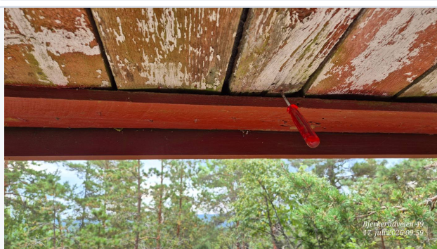
Råte i verandatak
