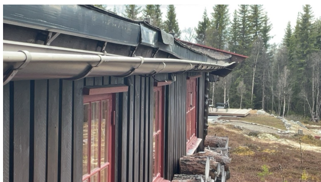
Skjevheter og feil fall på takrenne
