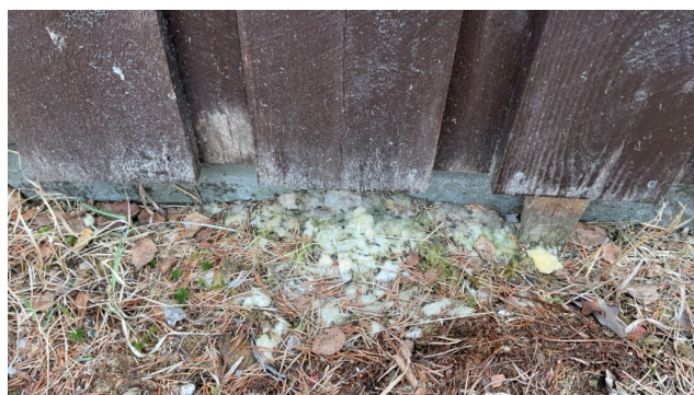
Spor av aktivitet og mulig skade i konstruksjonen
