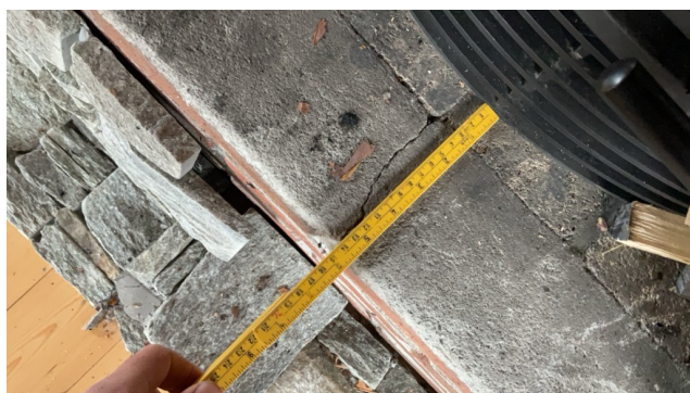
Avstand til brennbart materiale på gulv er for kort
