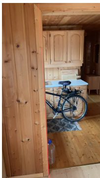
Skjevheter med loddavvik i vegger
