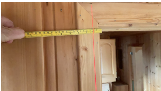
Målt skjevhet på oppmot 30 mm på 2 m høyde
