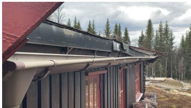
Det er registrert tydelige skjevheter og nedbøyninger i tak
