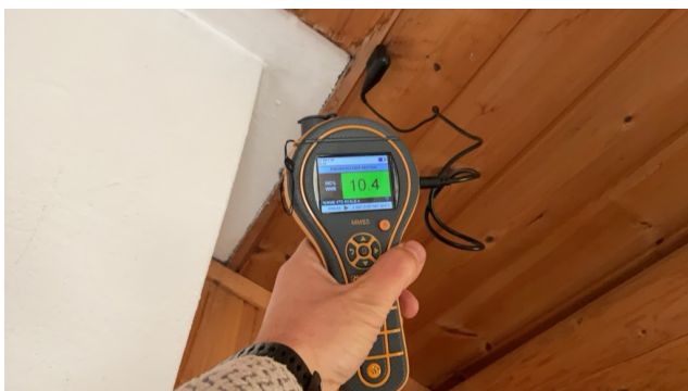
Fuktskjolder i himling fra pipestamme
