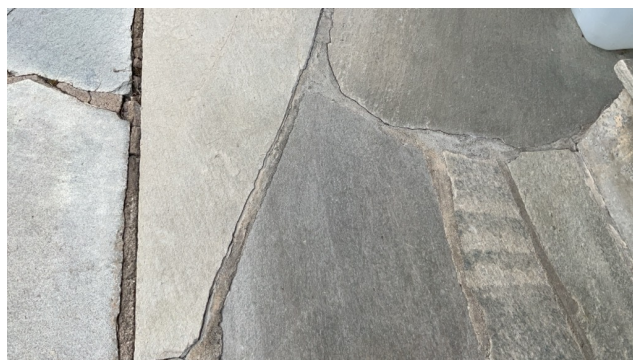
Sprekk i fuge
