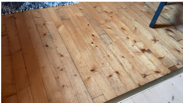
Slitasje på gulv her fra kjøkken og gang
