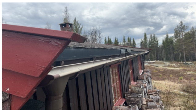
Skjevheter i takkonstruksjon
