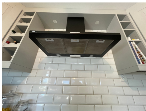
Bildet viser ventilator.
