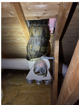
Bildet viser gjennomføring som ikke er i bruk.
