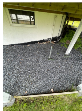
Bildet viser fyllestuss og lufting fra oljetank.
