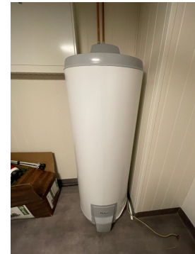
Bildet viser varmtvannsbereider.
