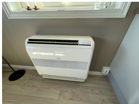
Bildet viser varmepumpe.
