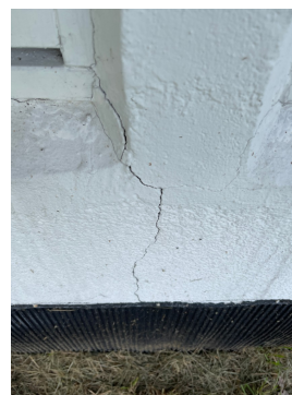
Bildet viser mindre sprekk i mur.
