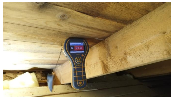
Måling tatt før utbedring ble utført.
