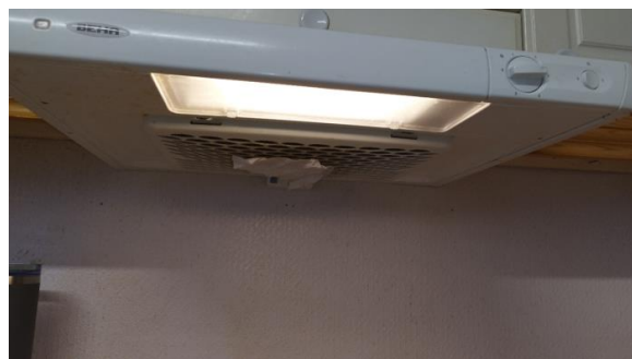
Test av ventilatoren.
