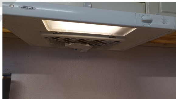
Test av ventilatoren.
