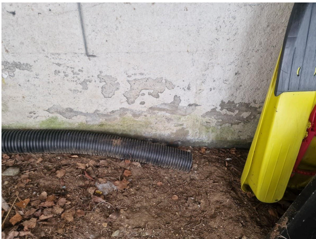
Bilde viser kjellermut under balkong mot vest.
