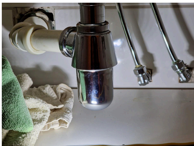
Bilde viser manglende rørmansjet rundt vannrør/avløpsrør fra servant som bryter membran i flisvegg.
