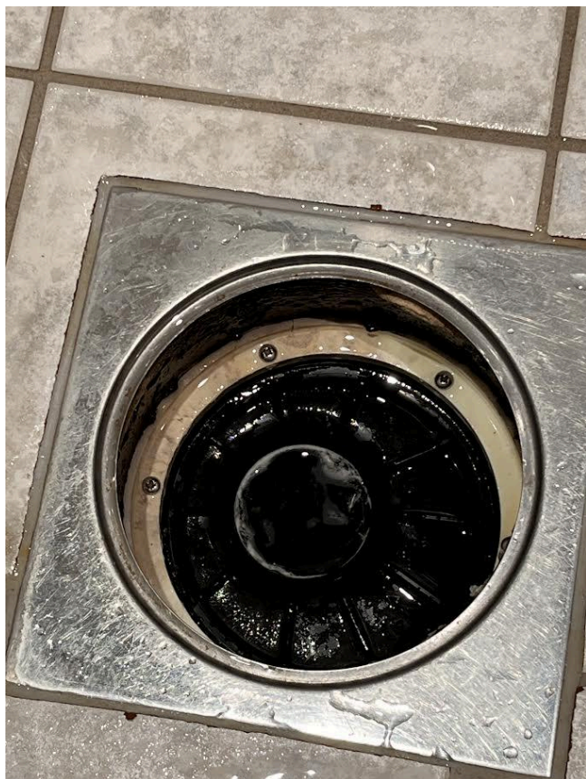
Bilde viser sluk uten slukmansjett og sluk er rengjort etter befaring; bilde mottatt fra eier.
