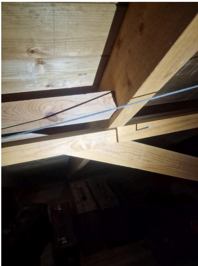
Enkel toppsvill(burde vært 2 stk) som er skjøtet mellom stolper i knevegg.
