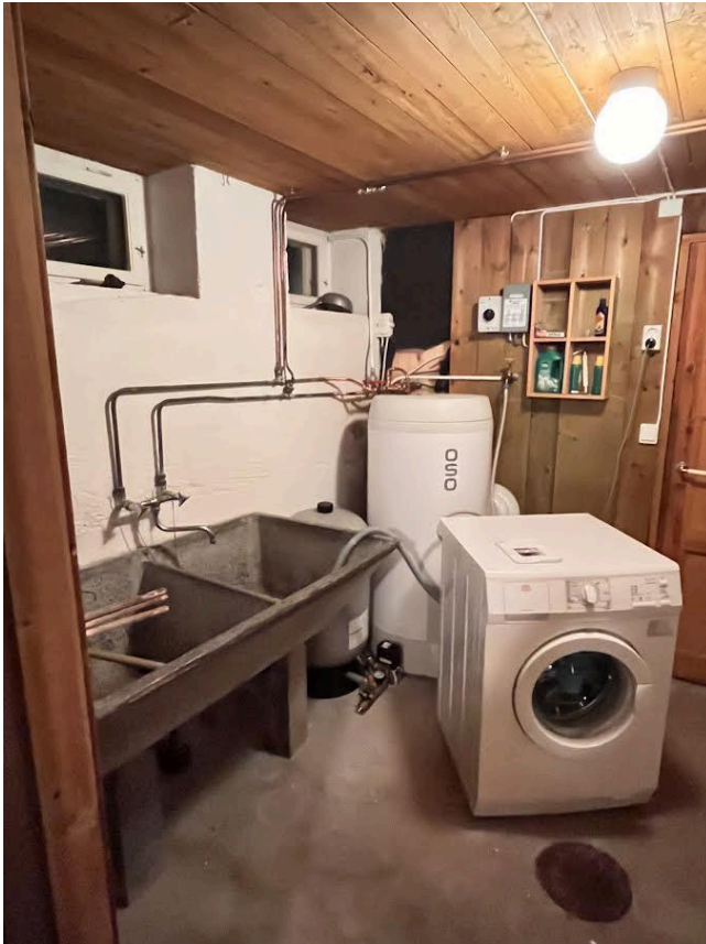
Bilde viser skyllekummer varmtvannsbereder ets.
