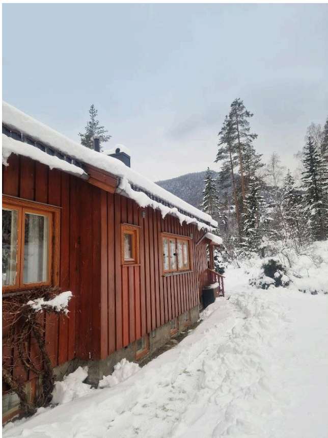
Bilde viser takrenne med istapper ved takfot.
