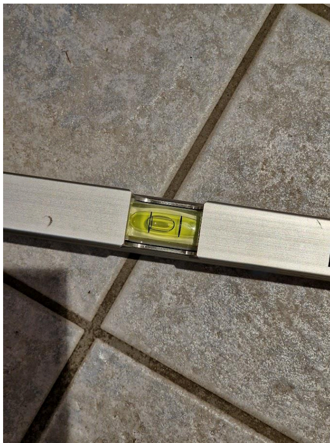
Bilde av vater viser fall på gulv.
