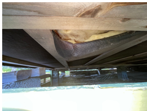
Manglende klemming av vindsperre i stubbeloft
