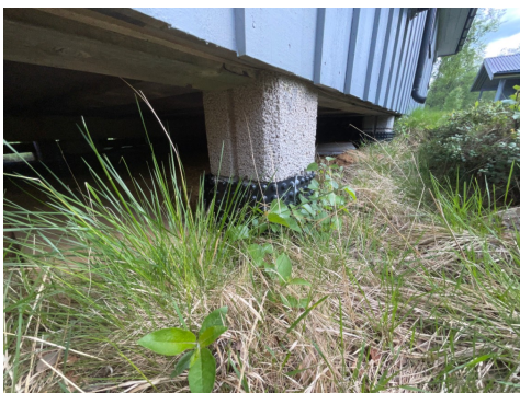
Manglende overflatebehandling av søyleblokker
