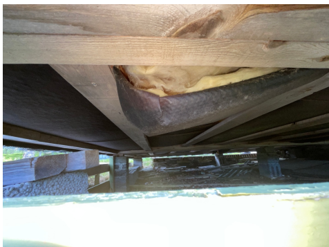
Manglende klemming av vindsperre i stubbeloftet, synlig isolering
