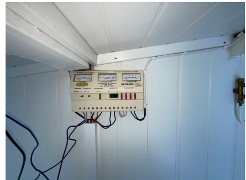
12 V fordelings- og ladetavle/ 12 V Sikringspanel
