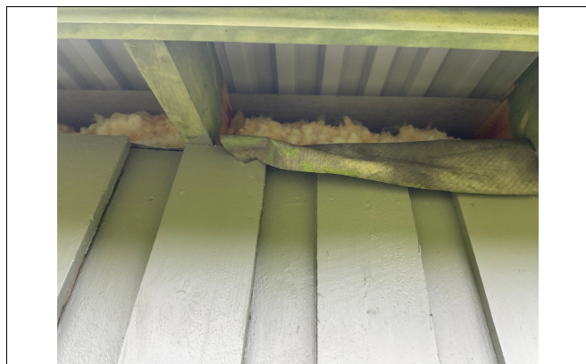
Uthus - Manglende underliggende kledning av takasser, og vindtetting av isolering ved raft
