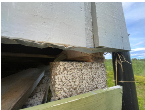
Søylepunkt (-er) mot nordøst/fasade nord forsøkt opprettet
