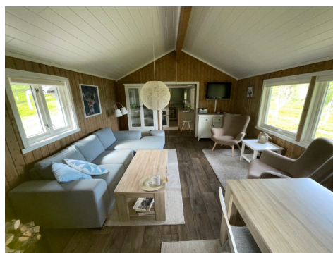
Overflater stue - svikt i gulv til venstre inngang stue
