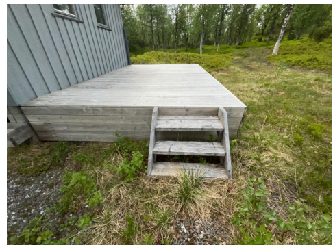
Trapp mot balkong, rekkverk mangler
