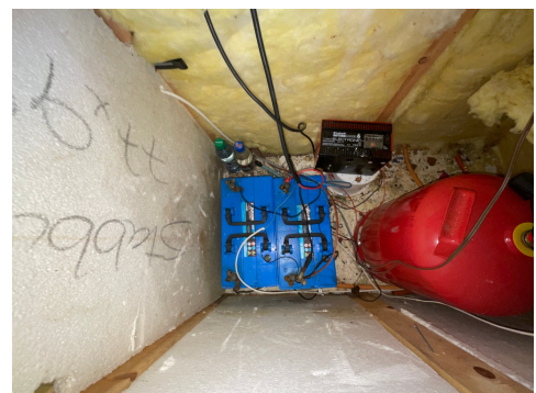
2 Batterier og 12 v batterilader
