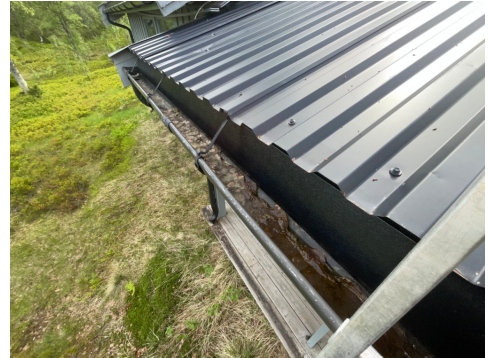
Mangelfull fall mot taknedløp
