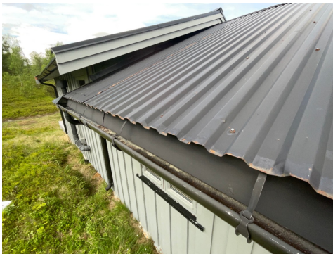
Rust på platender og innfestninger.
