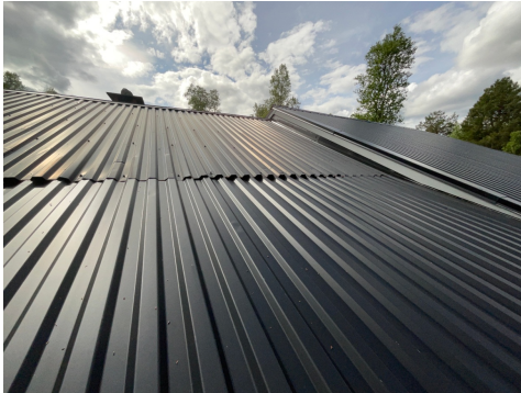
Mangelfull tilslutning mellom takplater i overgang.
