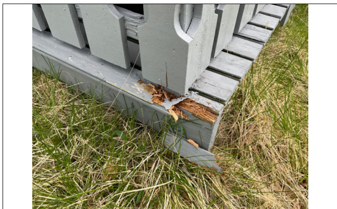
Uthus - råte i dekkebord og nedre del av vindskier
