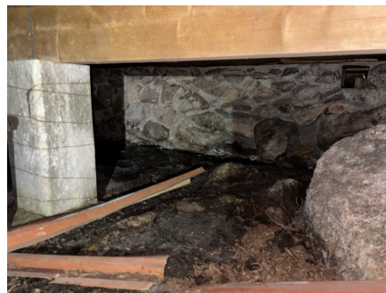
Det renner synlig vann på overflaten i krypkjelleren
