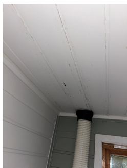
Taket på toalettet har misfarging
