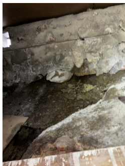
Det renner synlig vann på overflaten i krypkjelleren
