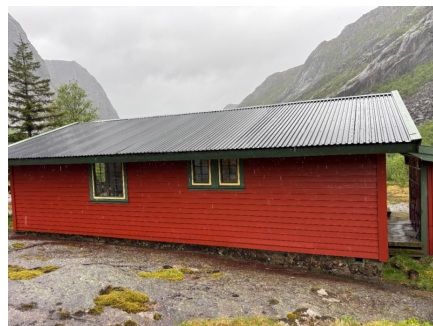
Det er ikke takrenne på denne siden av hytten
