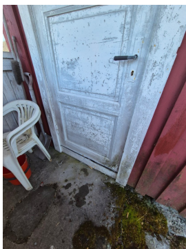
Fukt og råte flere steder i kledningsbord
