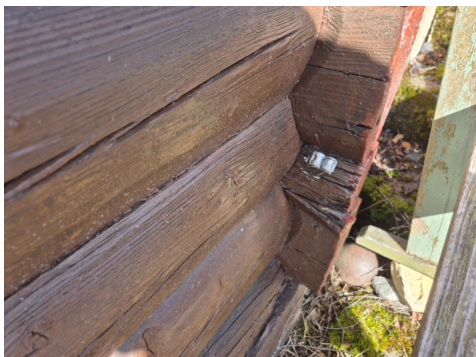
Råte i laftekonstruksjon
