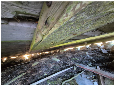
Fuktpåvirket treverk, bjelkelag og stubbloft i krypekjeller
