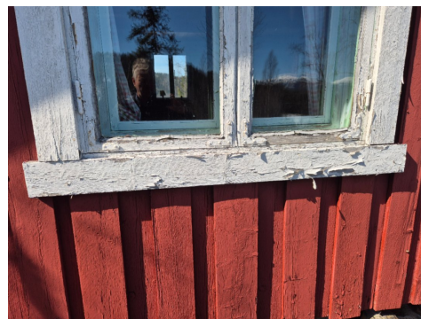
Stor slitasje på vinduer.
