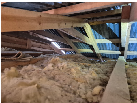
Ingen undertekking, medfører perioder med fuktighet fra kondensering på takplater.
