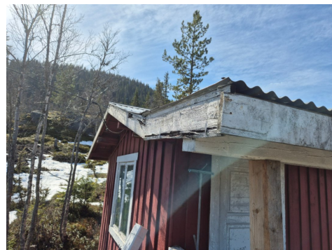
Råte og slitasje.
