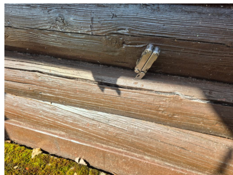
Råte i laftekonstruksjon
