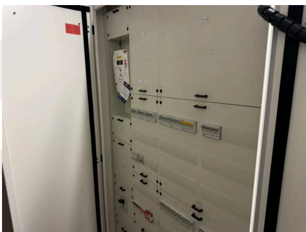
El-anlegger i stålhallen
