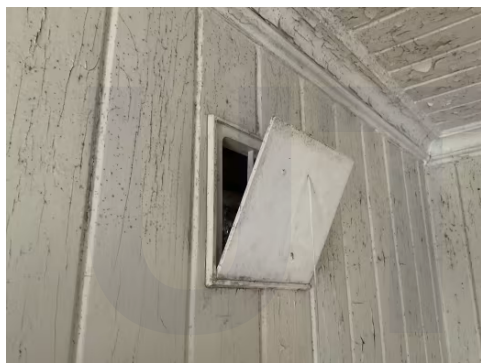
Naturlig ventilasjon via klaffventiler
