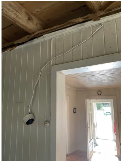
Mangelfull og løs innfestning
