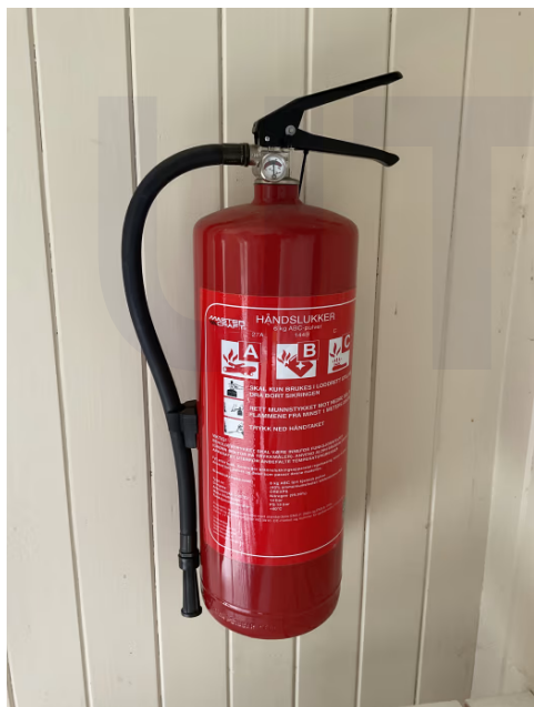
Brannslukningsapparat plassert i gang 1.etasje
