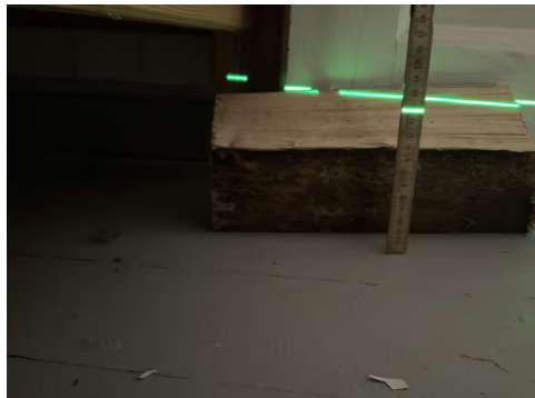
Målt avvik på 63 mm inne på soverom mot nordvest
