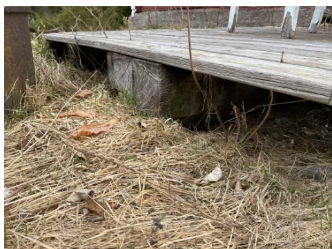
Ligger direkte på terreng og utsatt for fuktskader
