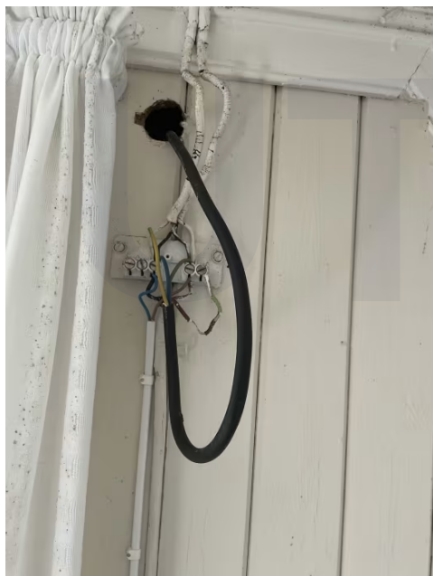
Koblingspunkt med skjøtledning
