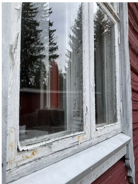
Installasjoner med generell slitasje
