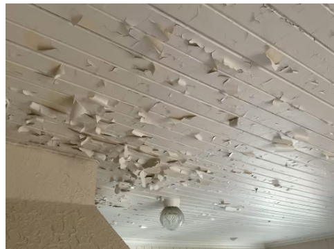
Overflater med generelt omfang av malingavflassing
