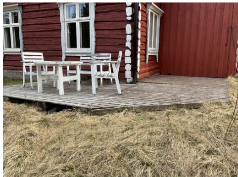
Terrasse platting med synlig skjevheter
