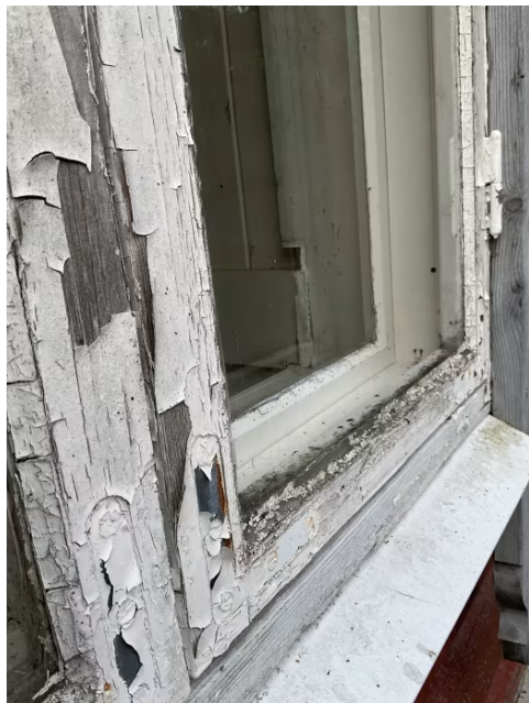
Utvendig og innvendig ramtre med generell slittasje
