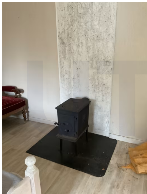
Ildsted soverom 2.etasje med vedovn
