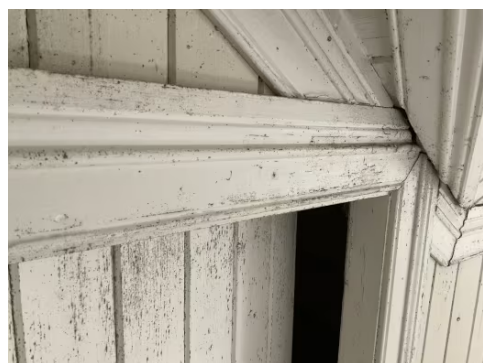
Overflater med svertesopp og slitasje
