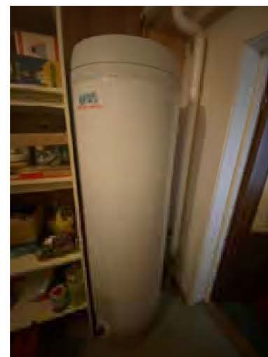
Bildet viser varmtvannstank plassert i bod i kjelleren.
