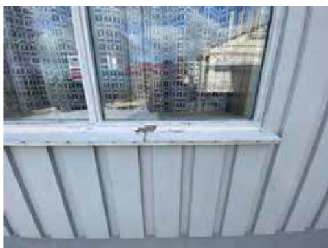
Bildet viser værslitt vindu med etterslep på vedlikehold.
