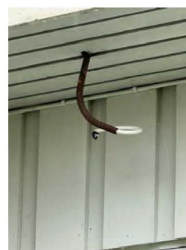
Synlige kabler, ikke fagmessig avsluttet. Anbefales nærmere undersøkt.
