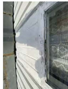
Bildet viser stedvis tørr og sprukket kledning.
