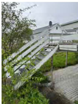
Bildet viser utvendig trapp fra veranda ned til terreng. Trappen mangler rekkverk på en side.
