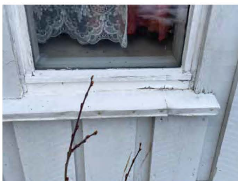
Bildet viser værslitt vindu med etterslep på vedlikehold.
