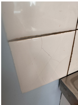
Bilde viser skade på flis på kjøkkenvegg, og manglende fuger mellom fliser.
