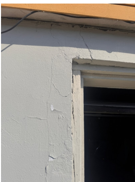
Bilde viser riss i utsparing for garasjeport.
