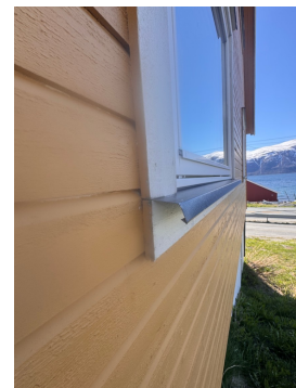
Bilde viser kort avslutning av beslag samt mangledne avstand mot beslag.
