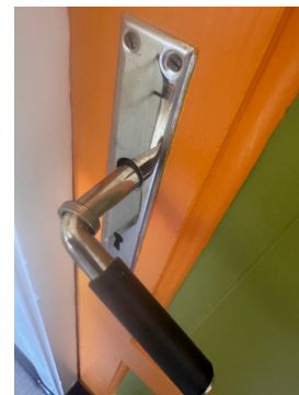
Bilde viser døre på etasje 2 med bruksslitasje lås/hengsler.
