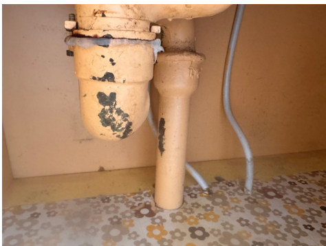
Bilde viser røropplegg under servant fra byggeåret. Eldre. Skader kan oppstå.
