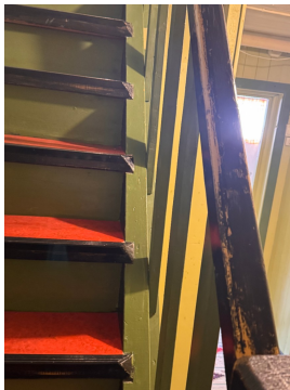
Bilde viser bruksslitasje rekkverk til trapp.
