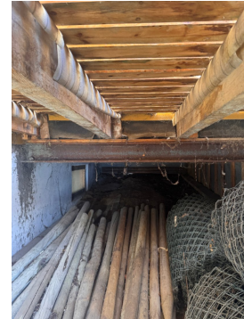
Bilde viser jerndrager og overlapping mot veranda under bolig.
