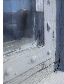
Bilde viser råteskader omramming for de eldste vinduer.
