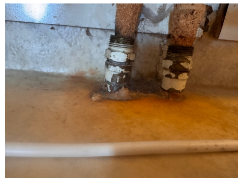
Rørgjennomføring på bad, eldre, ikke fuksikker grunnet lav oppbrett.
