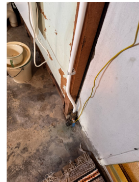
Bilde viser stoppekrane på vaskerom i kjeller.
