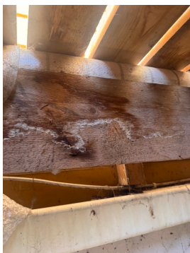
Bilde viser misfarge fra fukt på bjelke til veranda.
