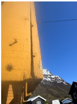
Bilde viser fuktsskader og råte i bunn av rekkverksbord til veranda.TG
