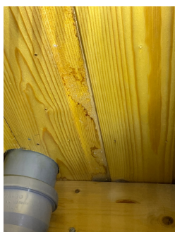
Fuktskjolder ved avløp i himling under badet.
