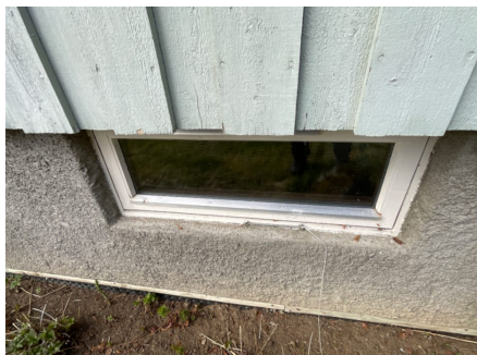
Mangler beslag under kjellervinduer.
