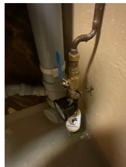
Stoppekran og vannmåler i vaskekjeller.
