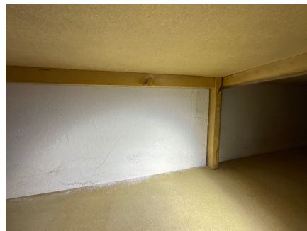
Kalkutslag på nedre del av grunnmur.
