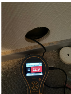
Fuktmåling som viser fukt over grensen for utvikling av sopp/råte.
