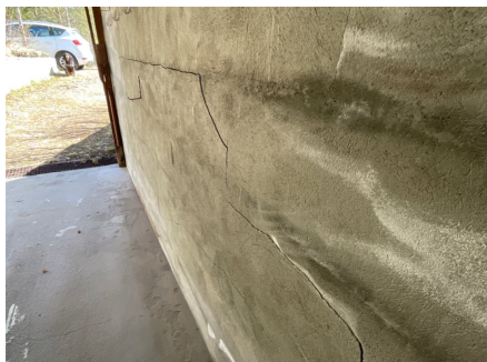
Sprekker i vegg i garasjedelen.
