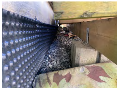
Fall på terrenget mot mur.
