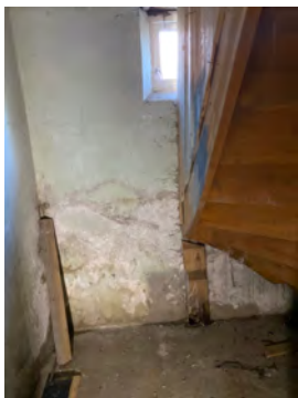
Råteskader i bærende punkt under trapp.
