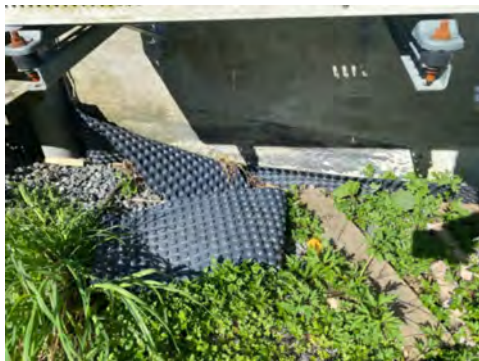
Fuktsikring mot muren mangler klemlist/avslutning i topp.
