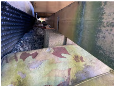
Manglende innfestning i bygningskroppen
