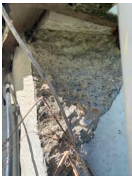
Manglende betong på mur ved hjørnet mot sørøst.
