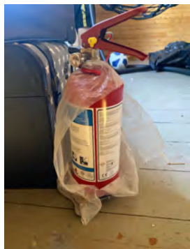
Brannslukkerapparat må byttes til min 6kg.
