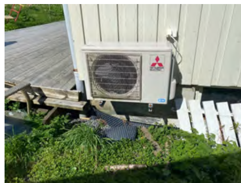
Varmepumpe utvendig del.
