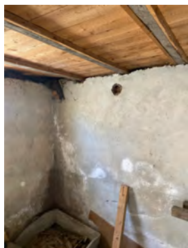
Fukt/saltutslag mot muren i kjeller.
