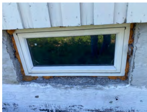
Kjellervinduer mangler beslag i nedkant samt manglende utvendig tetting.
