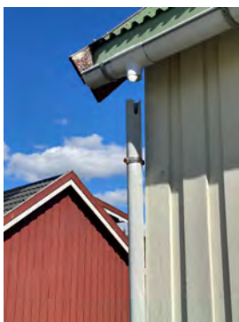
Skade/manglende tilkobling nedløpsrør
