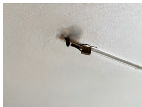
Tegn til varmgang på ledning i taket på stuen.
