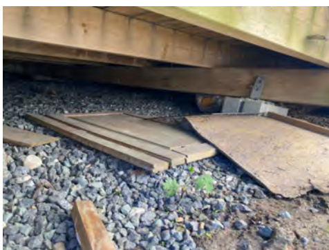
Skjevheter i fundamentering
