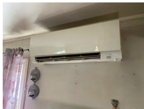
Varmepumpe innvendig del.
