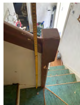
Rekkverk er såpass lavt at rekkverkshøyde bør økes.
