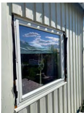
Manglende beslag/Utvendig tetting
