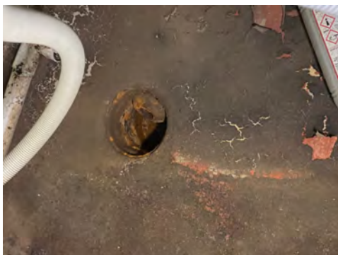
Tegn til tilbakeslag på vaskerom i kjeller. Det er påvist rust i soilrør.
