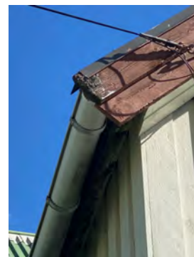
Påbegynte råteskader i vindskier.
