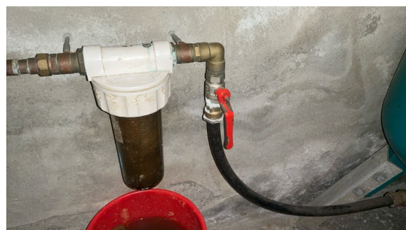
Vannfilter som må skiftes regelmessig.
