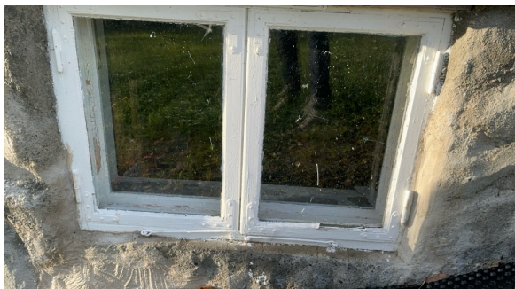
Vindu i kjeller, fasade sør. Kitt er løsnet.
