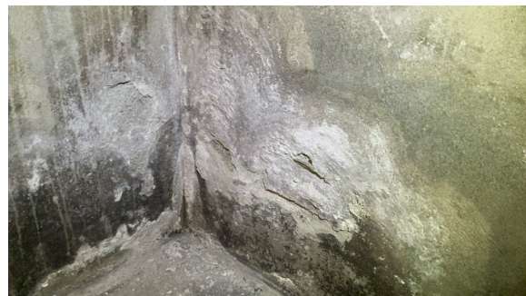
Saltutslag på mur og løs puss.
