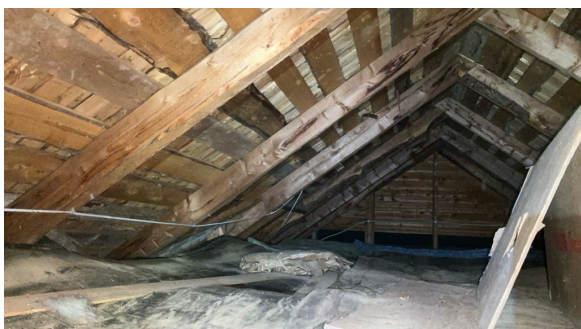
Møneloft hovedtak. Enkelte fuktmerker på sperrer/undertak er observert. Merker tydes å være gamle.
