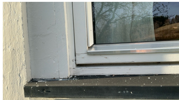
Oppsprekking i maling på vindusramme er observert på eldre vinduer 1. etasje
