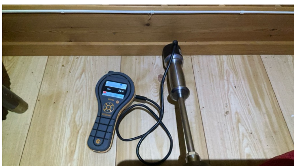
Fuktmåling med hammerelektrode i påforet vegg. Det ble målt verdier for skadelig fukt.
