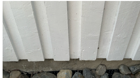
Sprekker nederst på kledning, samt stedvis løse malingsflak som følge av råte i kledning.
