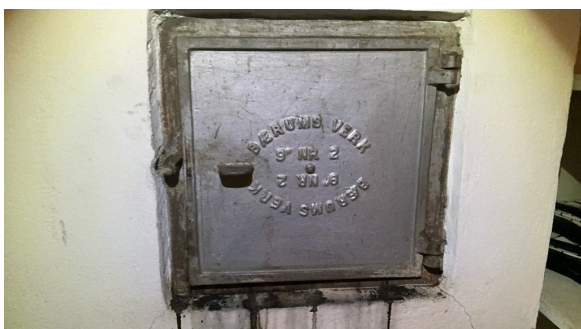
Sotluke på pipe i kjeller. Låsemekanisme er defekt, må skiftes.
