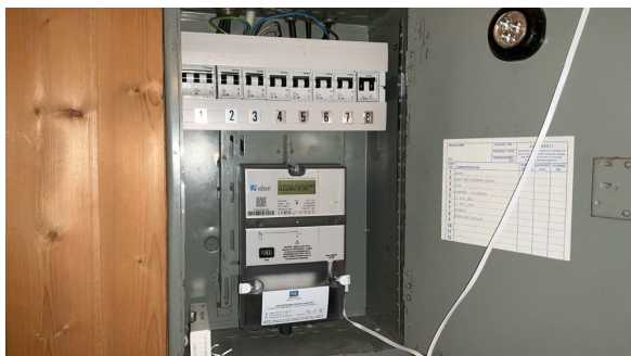
Sikringskap plassert på loftetasje.
