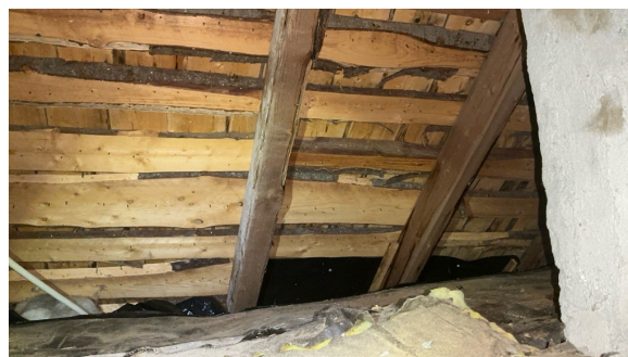
Møneloft hovedtak. Manglende lufting over skråtak-under undertak.
