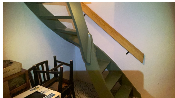
Manglende rekkverk i trapp til kjeller.
