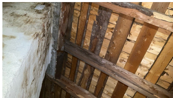
Fuktmerker registrert rundt pipe.
