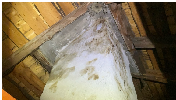
Pipe på loft. Rennemerker på puss er observert.
