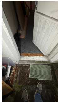
Kjellerdør i tre med glass. Værslitt
