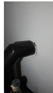
Sprekker i gjennomføring til pipen. Ukjent utførelse av tetting av tidligere hull. Det er ikke opplysninger om når dette er utført.
