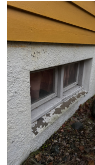
Stedvis områder med malingavskaling på mur
