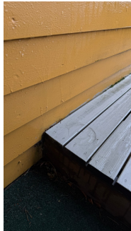
Kledning ligger bak veranda/terrassebord
