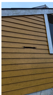
Eksempel spredte råteskader i kledning.
