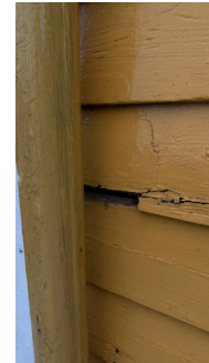
Eksempel spredte råteskader i kledning.
