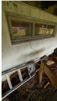
Riss/sprekke i grunnmur under vindu kjeller.
