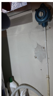
Riss i murpuss sett fra vaskekjeller
