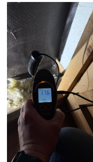
Fuktmåling i bunnsvill via luke i vegg. Det er registrert synlig isopor isolasjon i vegg.
