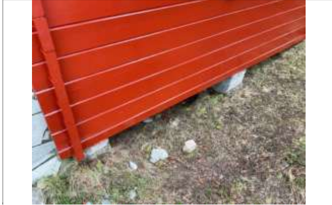
Pilarblokker som bæring av nneks uthus og badstuebygg
