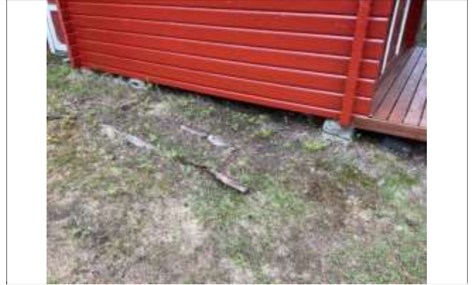
Kledning for for nært terreng
