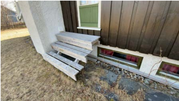
Trappa heller framover, svikt i fundamenter
