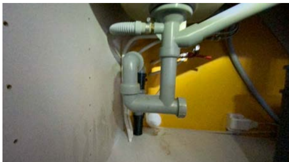
Avløpsrør i plast i kjøkkenbenk
