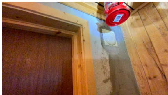
Ventil i vegg
