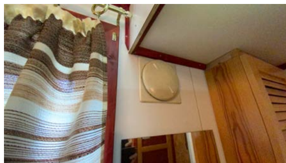
Ventil i vegg.
