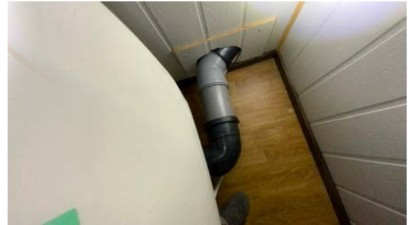
Avløpsrør inn i vegg.
