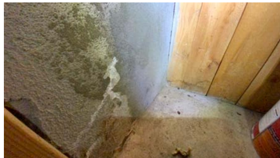
trevegg er ikke beskyttet mot fuktinntregning i nedre del.
