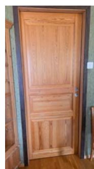
Skyvedør mellom kjøkken og stue er vanskelig å åpne
