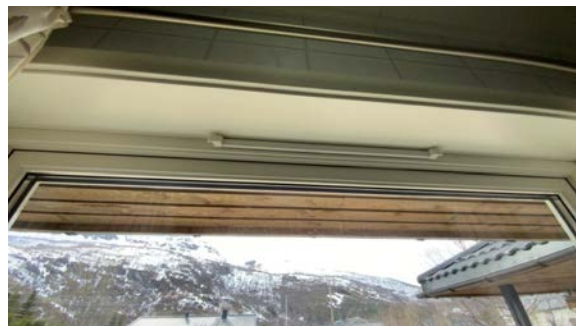
Ventil i vegg
