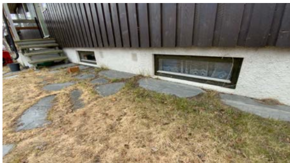
Vinduer er for nært terreng, uten beslag under.
