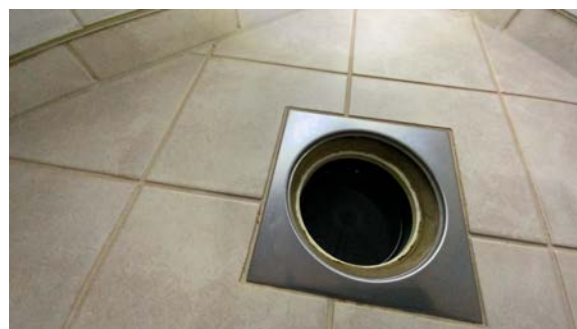
Sekundærsluk i dusjsone
