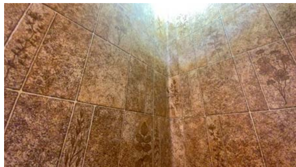
Tapet er løsnet /buler ut på vegger
