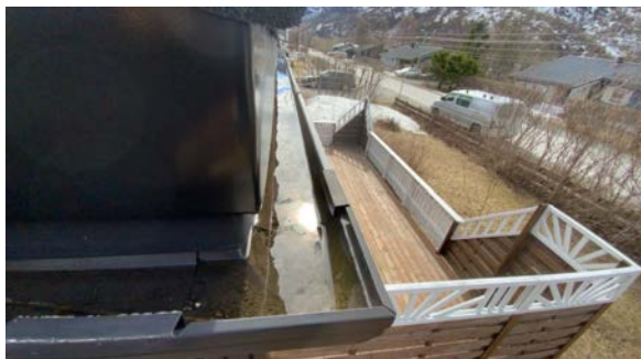
Står vann i takrenner
