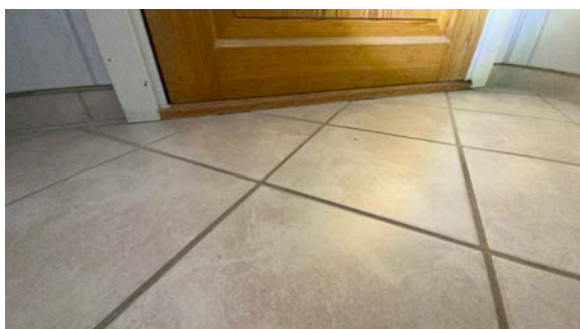
Tett ved dør, ingen luftespalte
