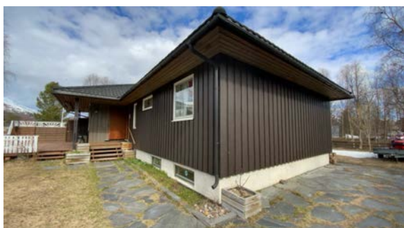
Takrennenedløp avsluttes over bakkenivå
