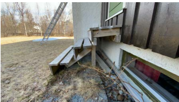
Svikt i fundamentering.
