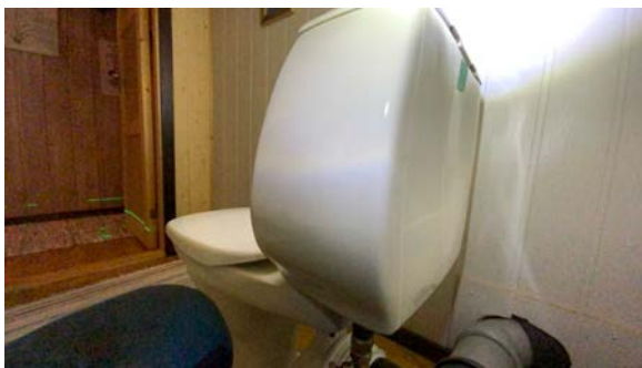
Lekkasje fra sistene
