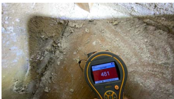
Forhøyet fuktverdier på gulv på boder
