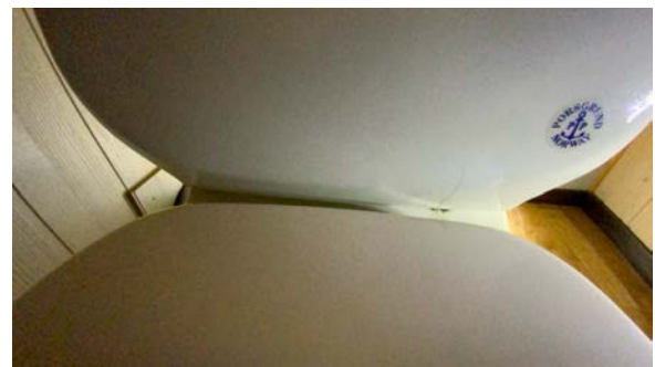
Sprekk i sistene
