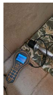
Fuktmerker i nedre del av vegg mot badet, ikke målt skadelig fukt
