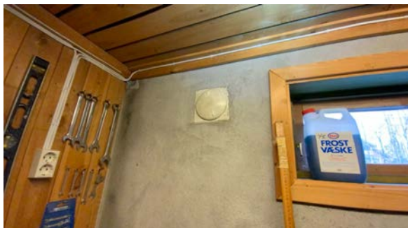
Ventil i vegg
