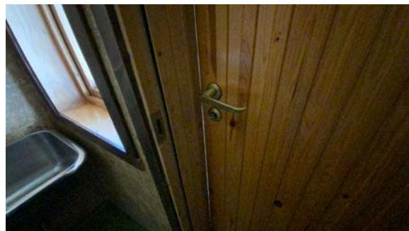
Dør tetter ikke mot karm
