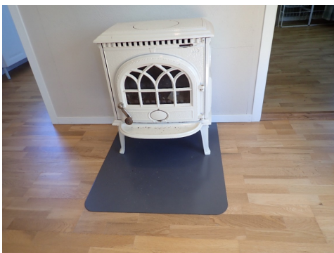
Ovn for fast brensel montert på stålplate
