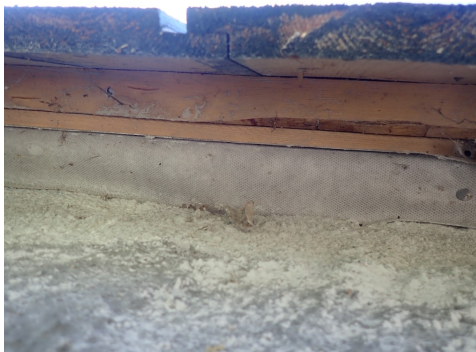
Ingen lufting er etablert
