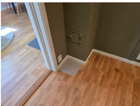
Flis på gulv under feieluke
