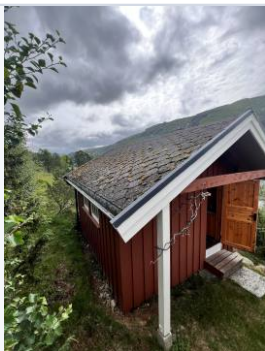
Taktekking vises en del mose på taket
