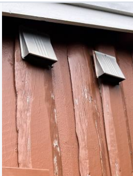
Ventiler i vegg på begge soverom
