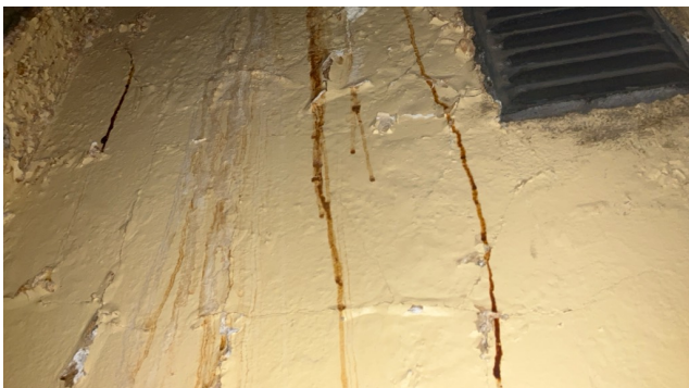
påvist noe lekkasje rundt pipe, dette er sannsynligvis eldre lekkasje
