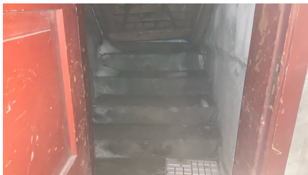
ytterdør i kjeller er gammel og uisolert
