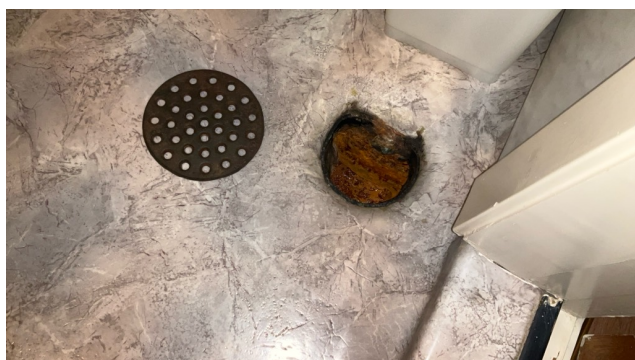
mangelfull fuktsikring av golv, mangler klemring på belegg i sluk
