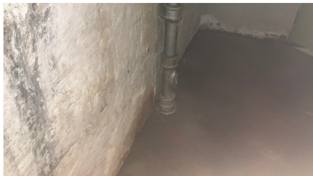
tegn til fuktvandring i nedkant av grunnmur og på golv enkelte steder i kjeller
