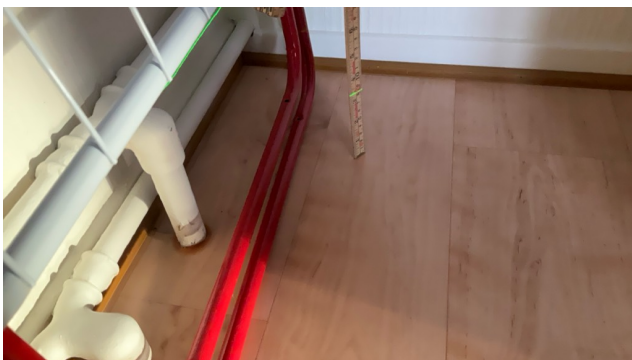
påvist høydeforskjell golv stue 2. etasje
