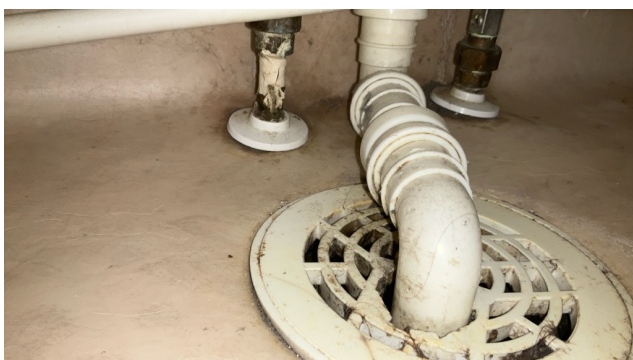
mangelfull gjennomføring av rør gjennom belegg, luft under belegget
