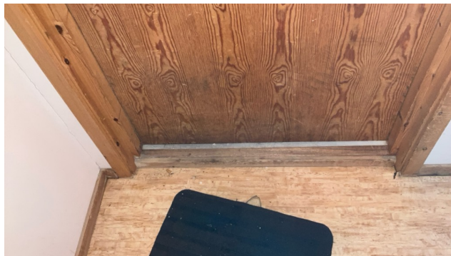
ytterdører har behov for vedlikehold
