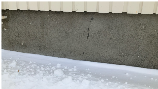
sprekk i grunnmur
