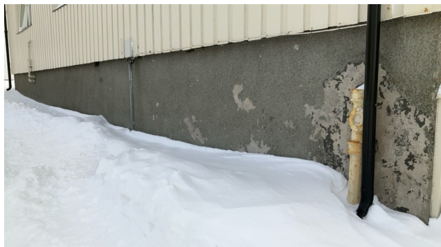
avskalling av puss og maling grunnmur
