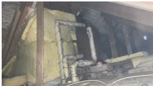
varmtvannstank på kaldt loft.
