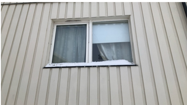
hybel 1. etasje nordvest et stk knust vindu
