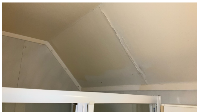
sprekker i tak
