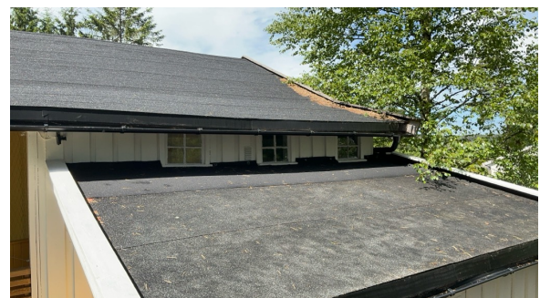
Papptecking på boden er ikke lagt bak kledningen, men utenpå kledningen.
