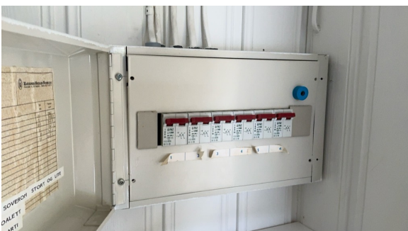
Sikringsskap med automatsikringer.
