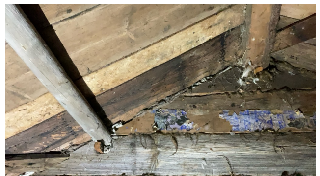
begynnend råteskade undertak
