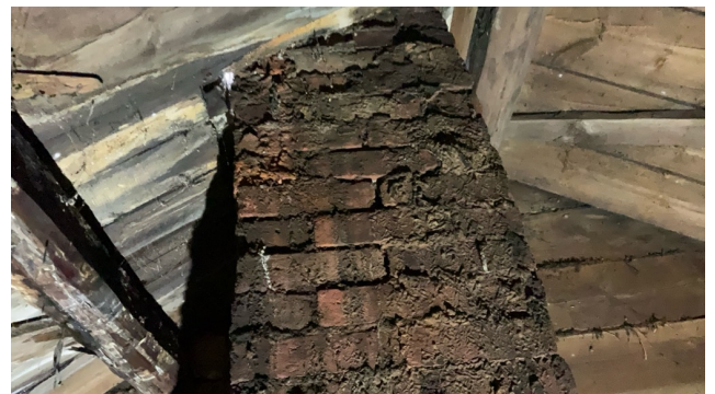
åpning ved pipe mangler beslag
