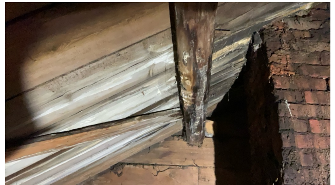
råteskade ved pipe
