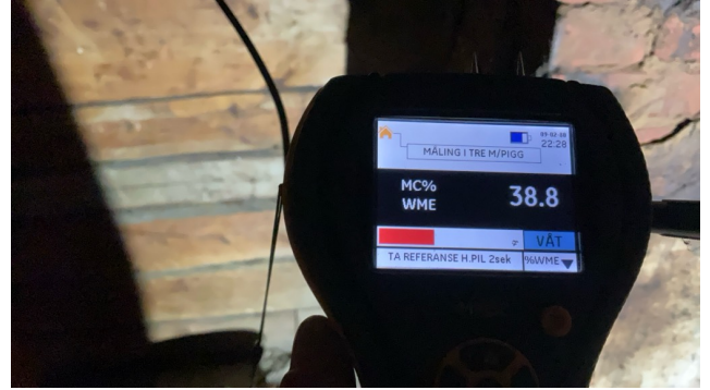
fukt ved pipe
