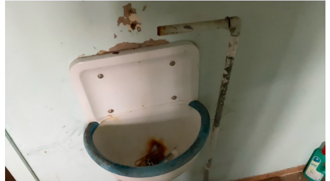
vannrør på kjøkken uten kran
