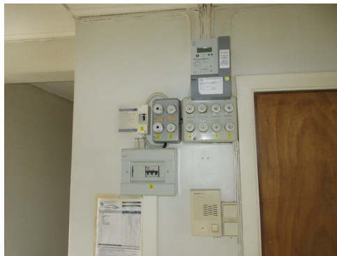
Sikringsbokser på vegg
