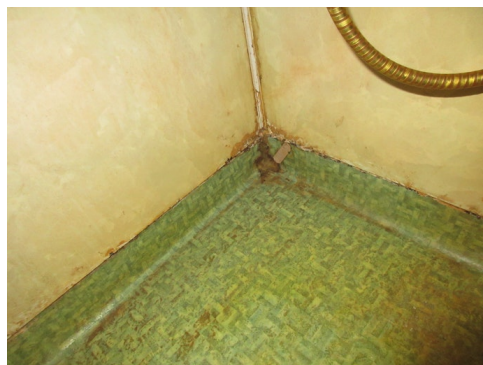
Skade på belegg i dusjhjørne
