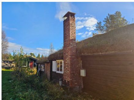
Pipa er høy over taket.
