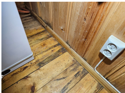
Svertesopp på golv-vegg.
