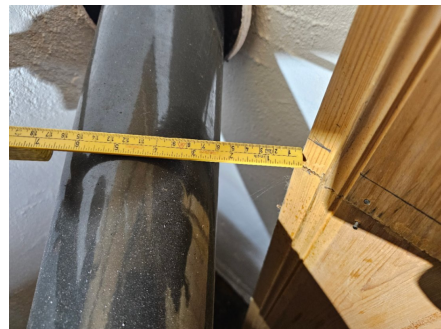
Røykrør for nært brennbart.
