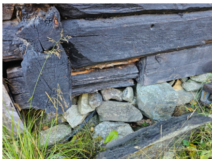
Dårlig sammenføyning av tømmer
