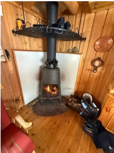
Ildsted med stålpipe i stue.
