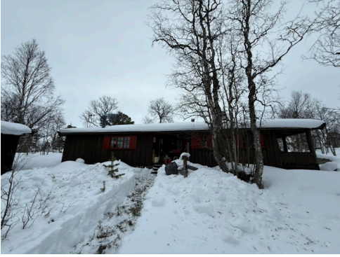
Takktekking dekket av snø.
