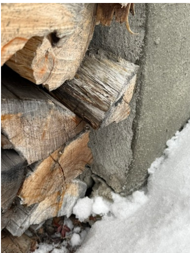
Horisontal sprekke i fundament mot terreng
