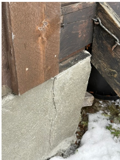
Vertikal sprekke i fundament.
