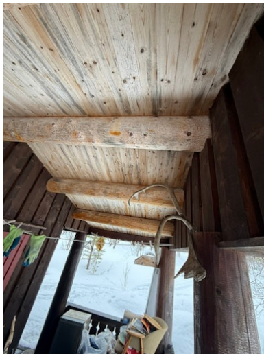
Svart/svertesopp i himling på terrasse
