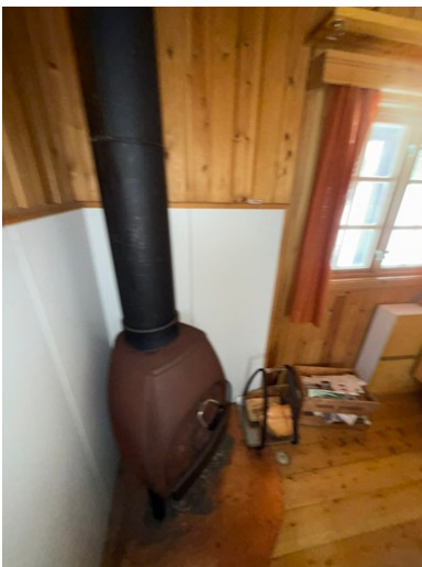
Ildsted med stålpipe på soverom ved kjøkken.
