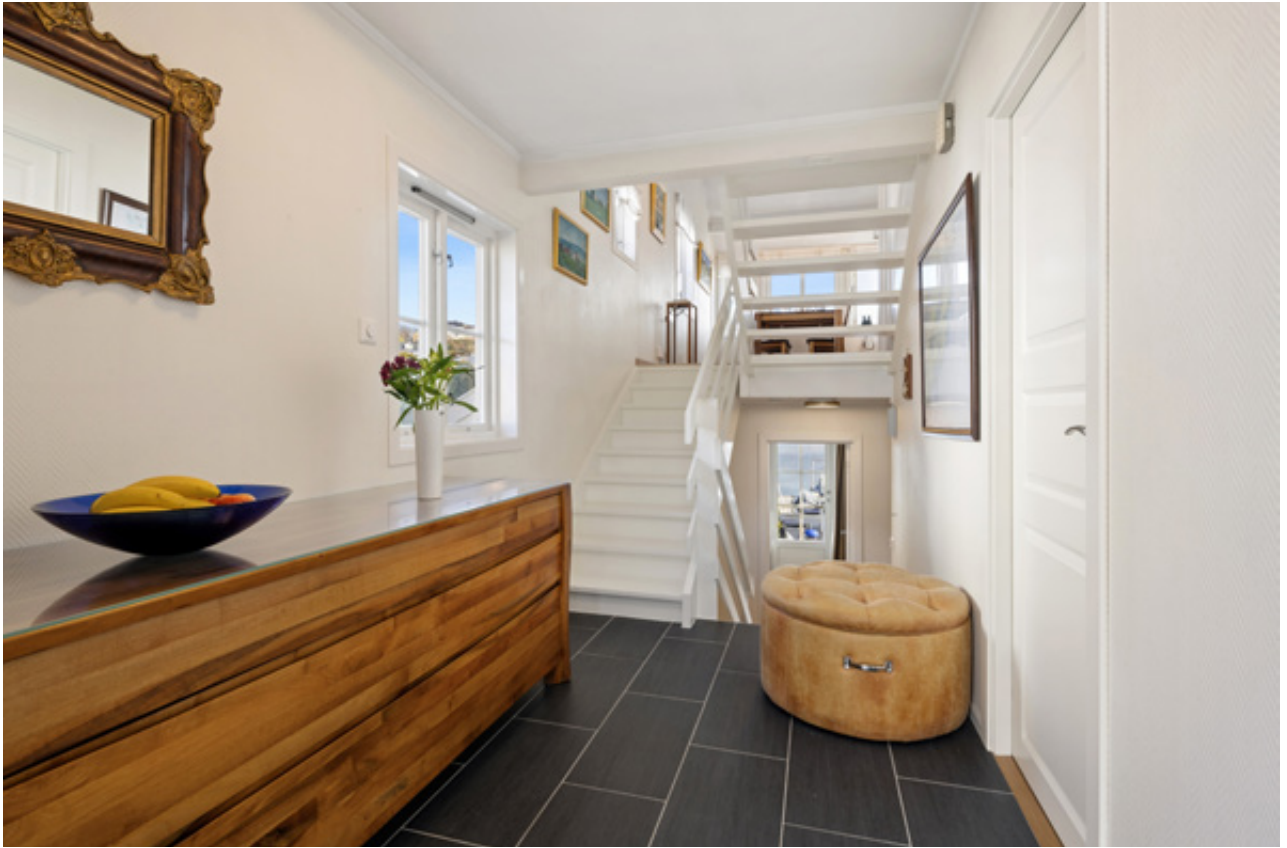
Entréen har et oppgradert sikringsskap fra 2024 og en ny stoppekran montert i 2025.
