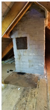
Pipeløp på kaldloft, med feieluke
