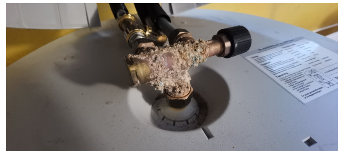
Kopling ved varmtvasstank
