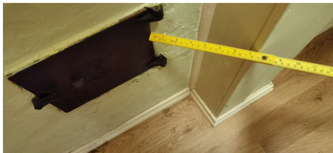
Sotluke i kjellar
