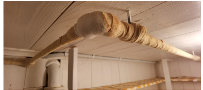
Innvendige synlege vassrør i underetasje
