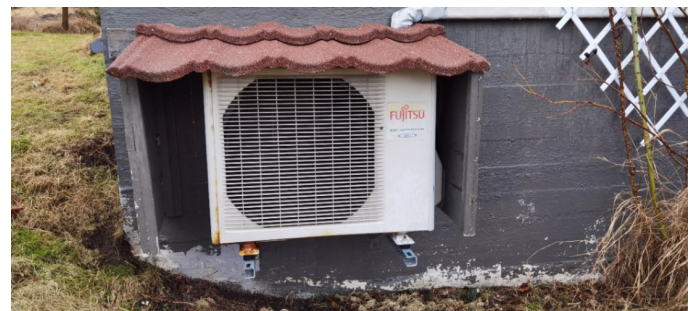
Utvendig del av varmepumpe
