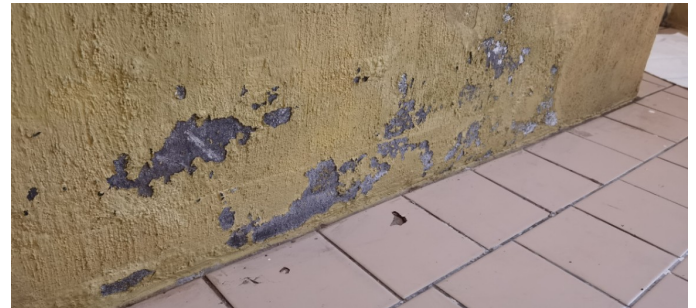
Avskalling av måling og saltutslag på vegg
