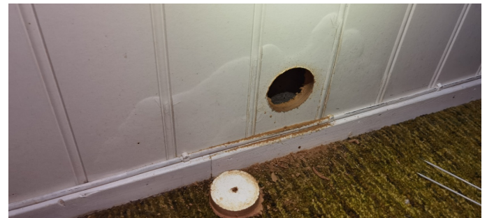
Oppfukta påfora vegg
